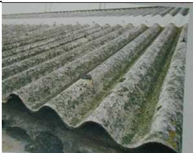
L'amiante est présent dans cette couverture en fibrociment
